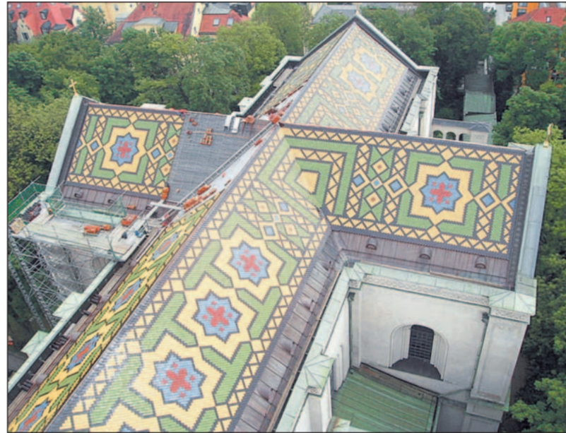
Die in Mustern verlegten farbigen Dachziegel der Pfarrkirche St. Ludwig in München mussten zum Teil erneuert werden. FOTOS: SPAENLE
